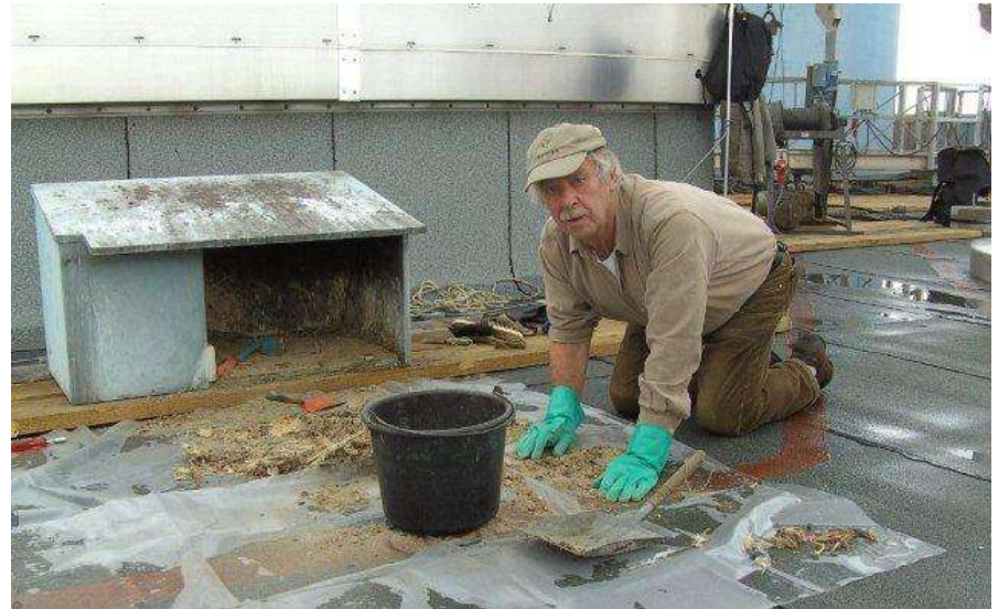
Horst Friedrichs bei der Kasten-Reinigung
